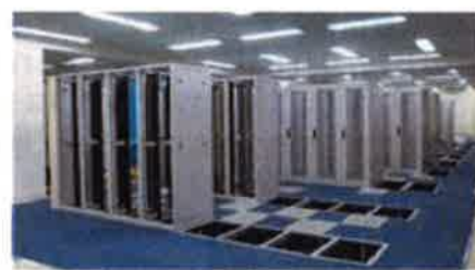
免震サーバー室の床全面に免震装置を採用
